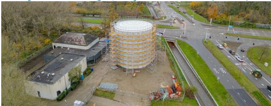
Afbeelding 1.3 Voorbeeld van een (groot) bovengrondse buffervat in Utrecht [bron: Eneco]
