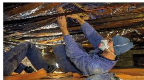
Kruipruimteisolatie (bron: Tonzeil)
